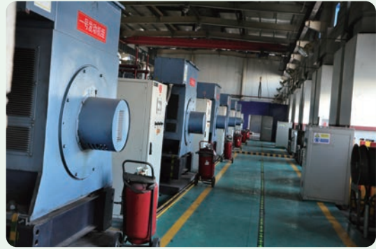
瓦斯發電機組
